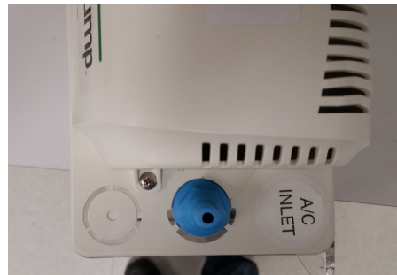
Figure 2 – Entrée AC (air climatisé) située à côté du clapet antiretour sur le dessus du NT1-P
